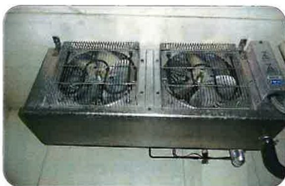
冷蔵庫内正常な冷却器外観
