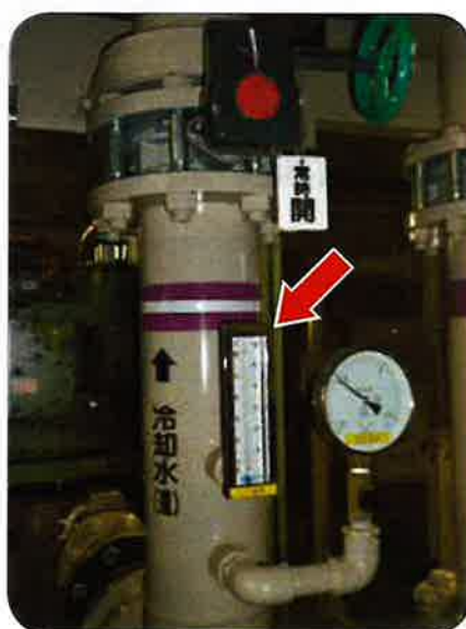
冷却水出口温度計確認
