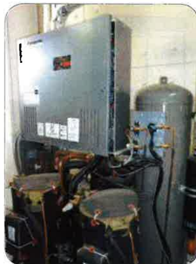
機械室内部にある冷凍機
