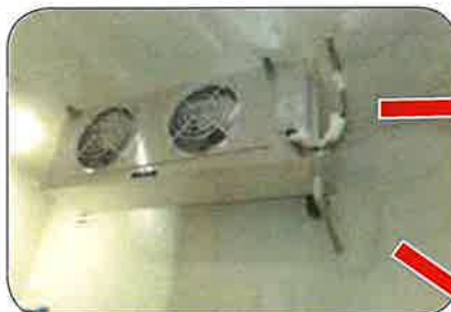
冷凍冷蔵庫の冷却器
