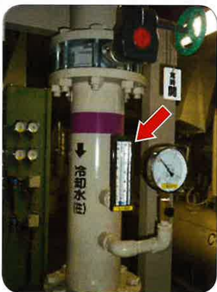
冷却水入口温度計確認
