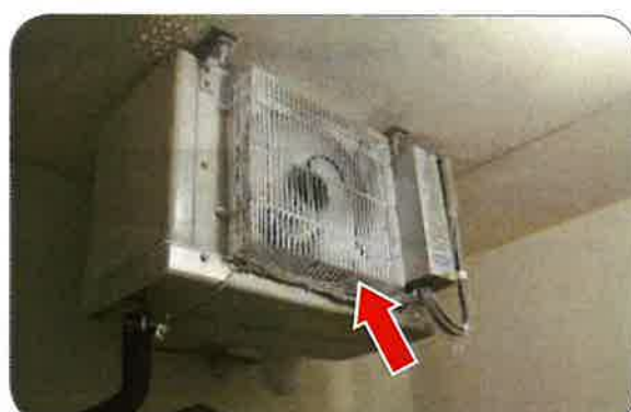
冷却器の内部霜付き異常
