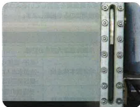
受液器液面計の液面位置
