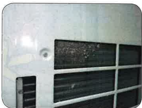
室外機に付着したゴミ
