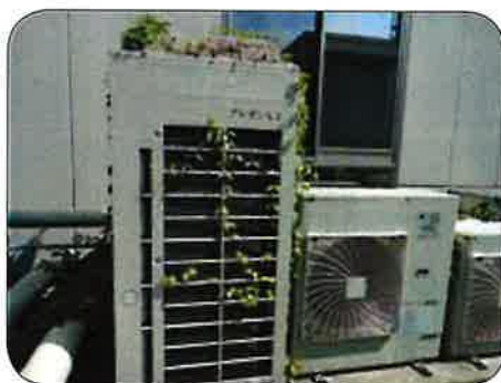
草で覆われた室外機
