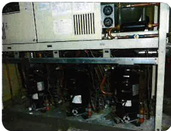
ユニット型冷凍機の異常振動確認
