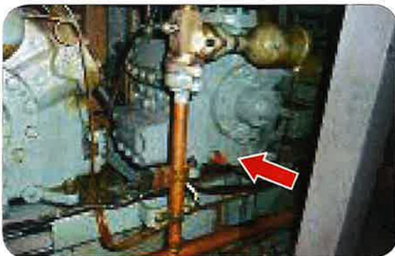
圧縮機周辺の油のにじみ状況
